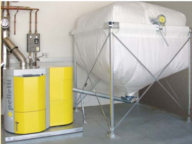
Abb. 11.2: Beispiel für ein Pelletlager mit Sacksilo und Austragung (Foto: Paradigma, Karlsbad)
